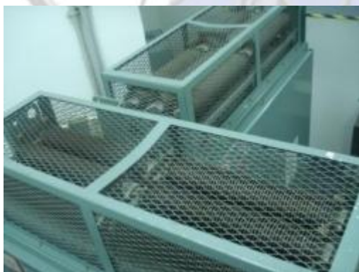
电梯控制箱上大量的散热管
